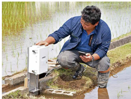
自動給水ゲート「パディッチ」(なんすん地区)
