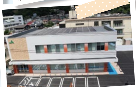
屋上太陽光発電システム
