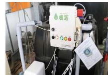
伊豆の国苺委員会 ナノバブル水製造装置
